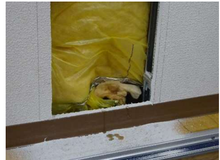
壁の断熱材・グラスウールも吸水→交換
