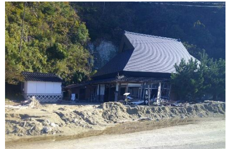
写3 真浦での土石崩壊、民家損傷
