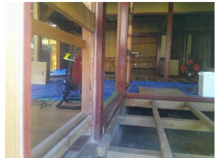
写9 住宅床下を乾かす 左柱裏に大型扇風機可動中
