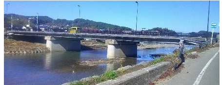
写8 上新橋にて流木が川を堰止め 上写10/24;枝等がひっかかり。 下写11/8;ではひっかかり材を撤去。仮水道管の設置
