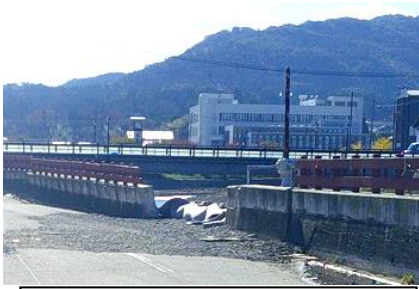
写6 河原田川右岸の堤防破損壁
