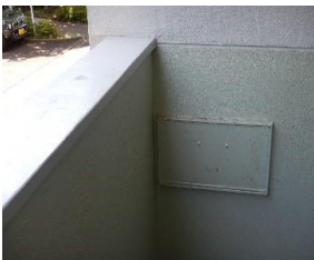
階段室踊り場のゴミ投入ダクト、今は閉じている
