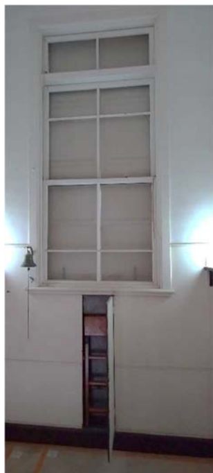
階段踊り場の壁面に埋め込まれたはしご
