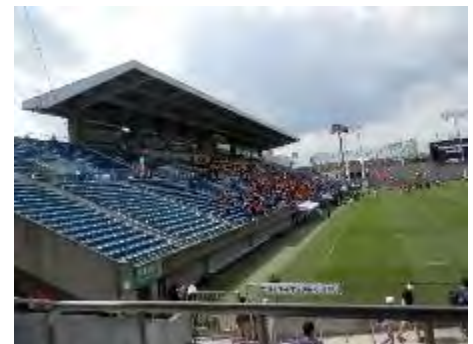
部分補強が必要な西側スタンドの屋根
