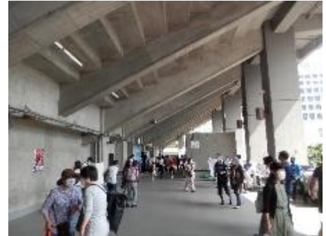
2階テラス、メインスタンド裏。コンクリート肌は古びていない。メインスタンドは一部補強が必要だが全体的に耐震改修の必要はない。
